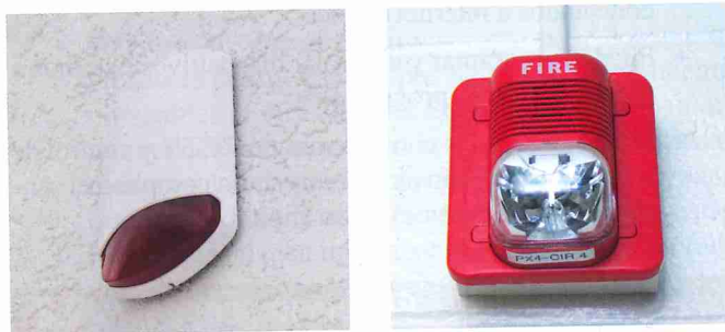
Figura 2.25. Gabinetes de sirena exterior.
