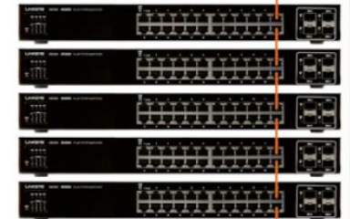
Switch en anillo.
