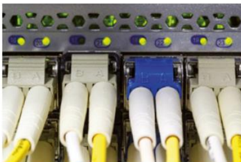
Latiguillos de cable de fibra óptica conectados a switch de fibra óptica.
