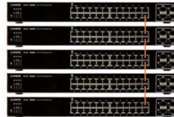
Switch en cascada.
