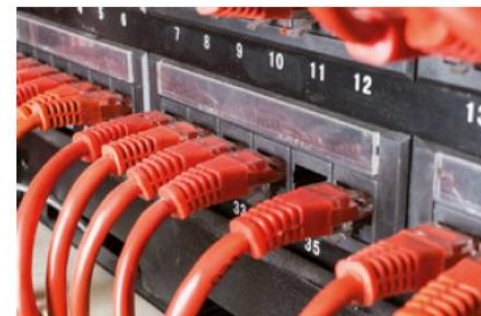
Uso de latiguillos de cable de par trenzado en paneles de parcheo.
