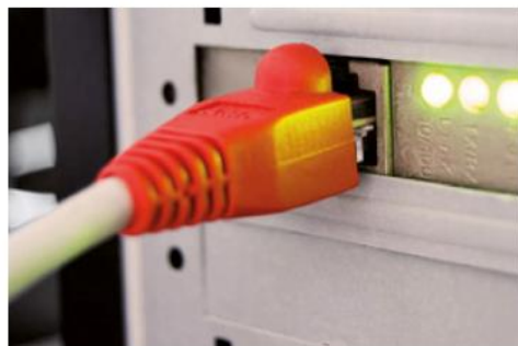
Latiguillo de cable UTP conectado a tarjeta de red.
