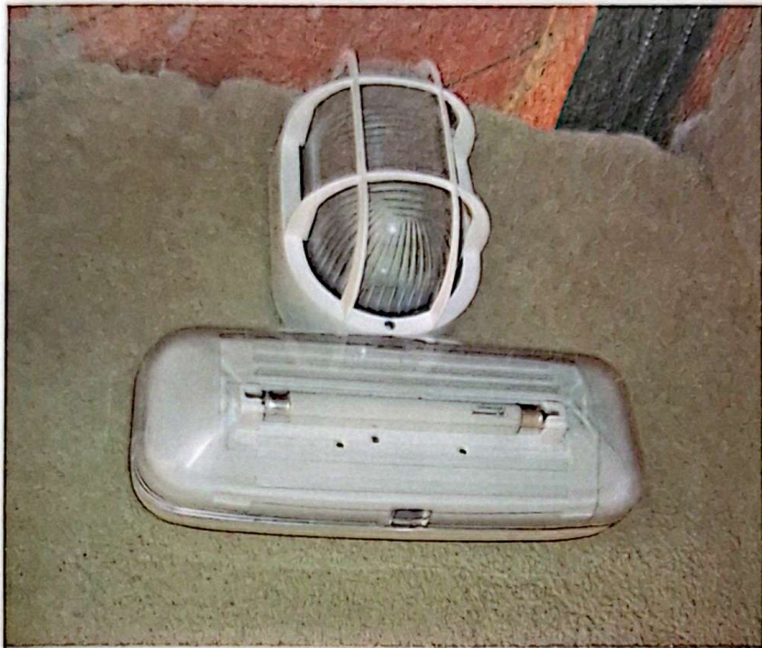
Figura 1.26. Iluminación de los recintos de telecomunicaciones.
