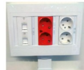
Caja de mecanismos en superficie.
