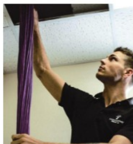
Cableado hacia una bandeja situada en techo técnico (cortesía de LG Networks).
