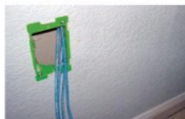
Detalle del extremo de cableado del lado de la toma del área de trabajo.
