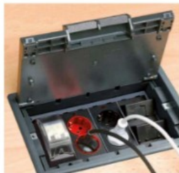
Caja de mecanismos instalada en suelo técnico.
