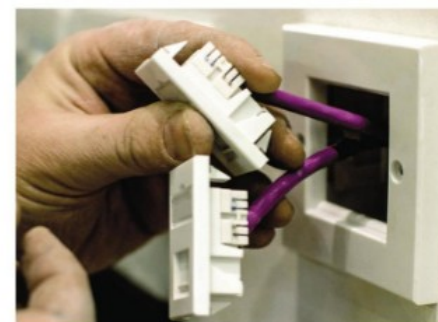
Mecanismos instalados en una caja empotrada.
