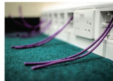
Resultado del rotulado y recorte de cableado en una zona de la instalación (cortesía de LG Networks).
