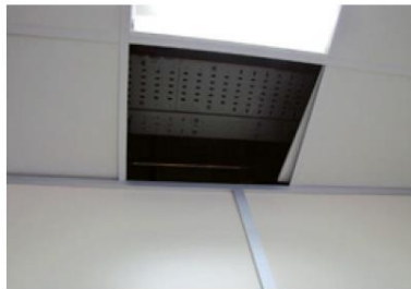
Canalización en techo técnico
