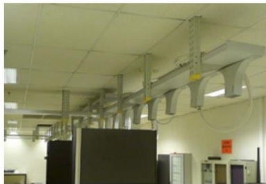
Canalización en techo
