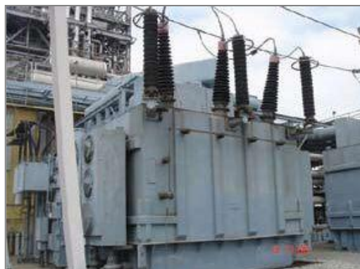
Transformador elevador (central eléctrica)
