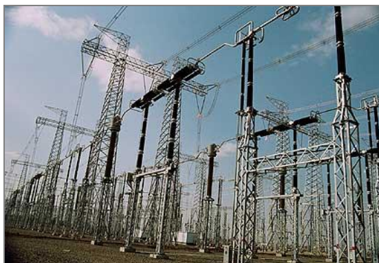
Subestación transformadora: reductor preto dos núcleos urbanos
