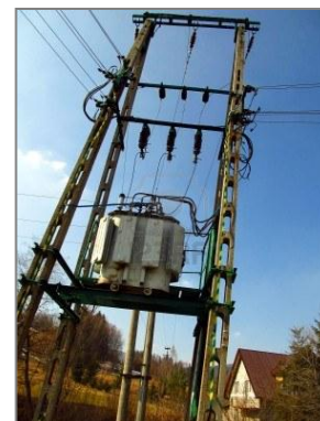
Transformador de baixa tensión
