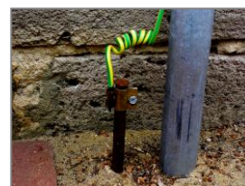
Cable toma de terra e pica soterrada
