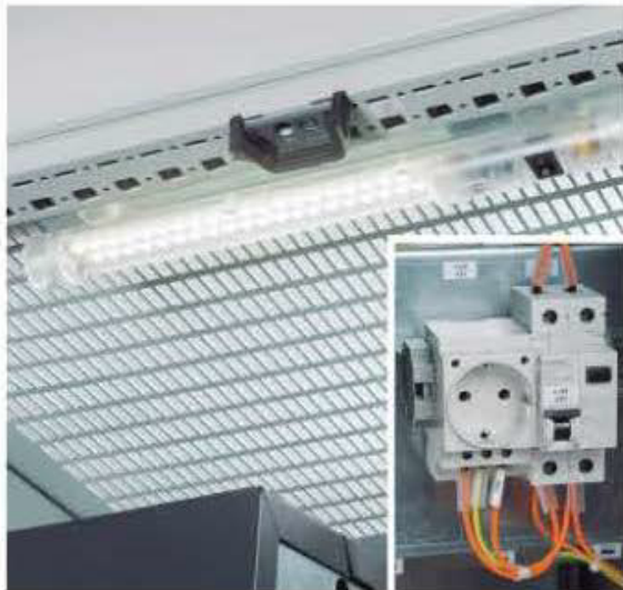
Figura 2.47. Iluminación y toma de corriente en armario.
