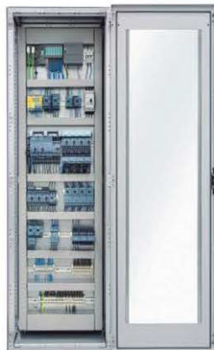
Figura 2.22. Armario de automatismos.
