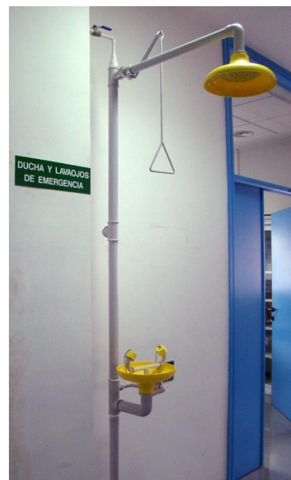
ducha y lavaojos de emergencia
