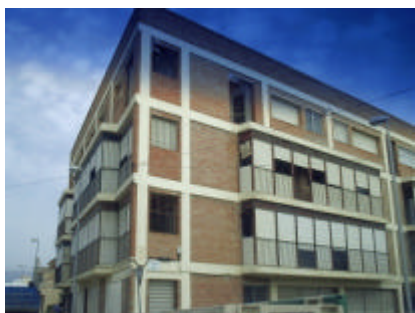
Este edificio está deteriorado.
