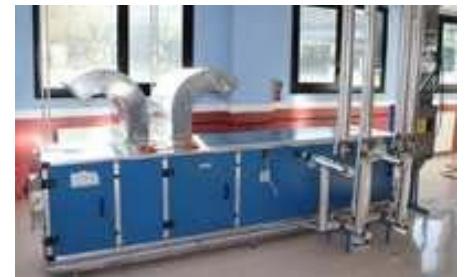
Fig. 24: Unidad de tratamiento de aire.
