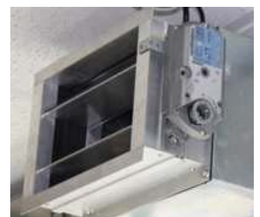
Fig. 27: Servomotor instalado en una rejilla con ajuste del caudal de aire.
