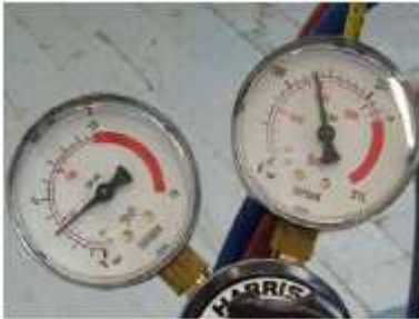
Fig. 40: Detalle de los manómetros de alta y baja presión.
