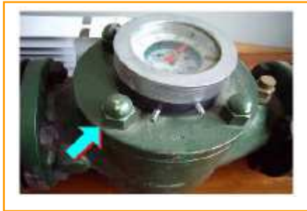
Fig. 46: Tuercas hexagonales cerradas en un contador de agua.
