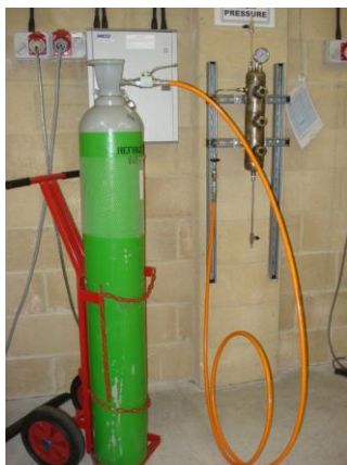
Figura 10, bombona conectada al equipo de carga
