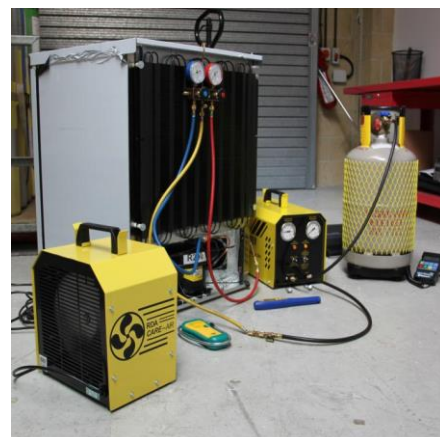
Figura 5, ejemplo de equipos utilizados para la puesta en servicio de sistemas de HC
