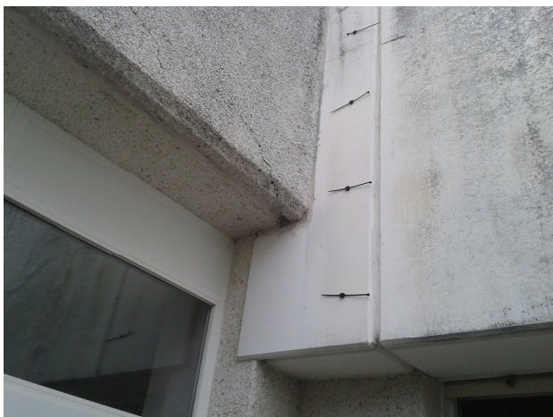
Colocación dos tojinos de suxeición con bridas ao longo da parede exterior.
