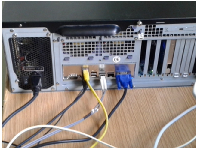
Vista posterior do servidor, onde se aprecian as conexións de rede de fibra óptica, mais a UTP.
