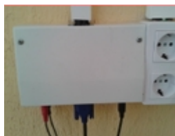
caixa de conexións
