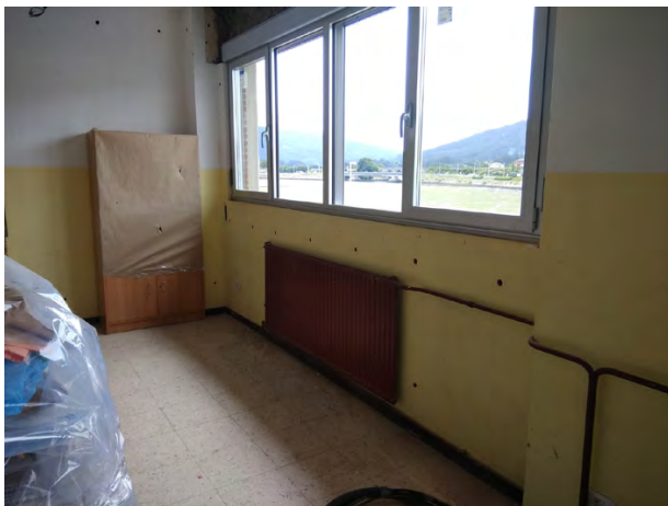
Fig. 15 Inxección de illamento en cámara (imaxe 1: perlas EPS en cámara. Imaxe 2: buracos interiores).
