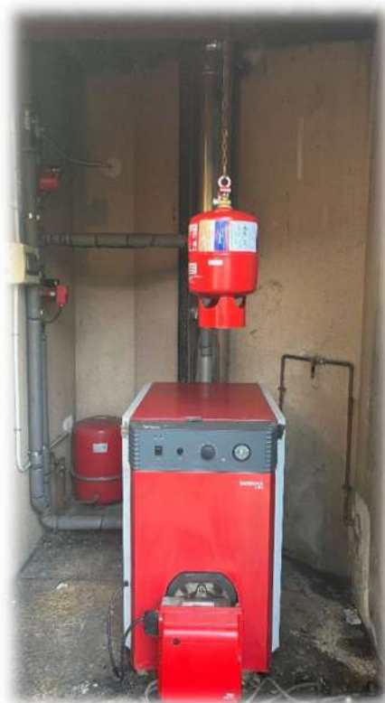
SALA DA CALDEIRA-EDIFICIO INFANTIL
