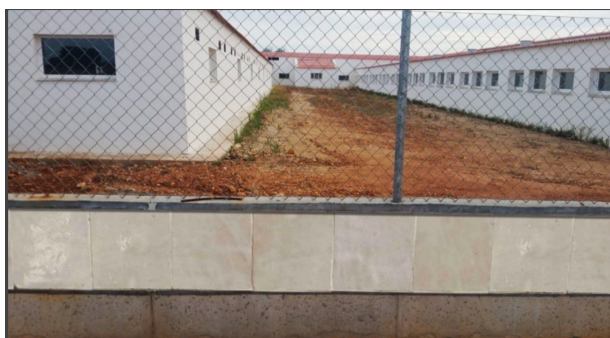
Valla con malla y poste metálicos
